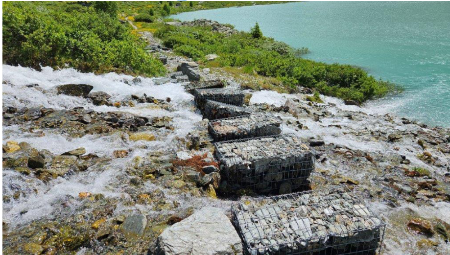
Water «Handling before»
